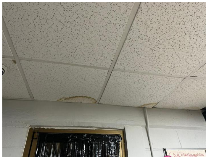
Imagen 3. Problemas de goteras
